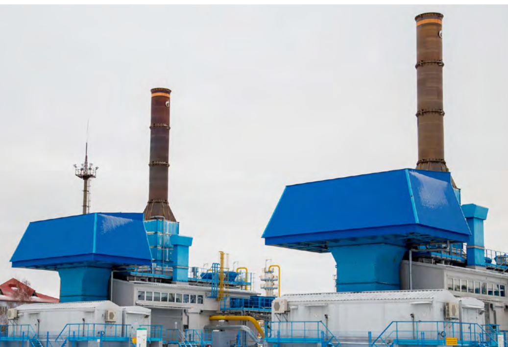
Газоперекачивающие агрегаты Касимовского ПХГ
