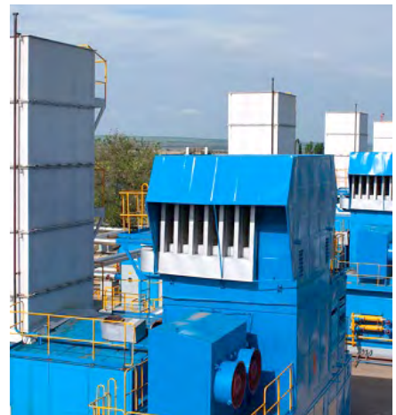
Компрессорная станция Ставропольского УПХГ
