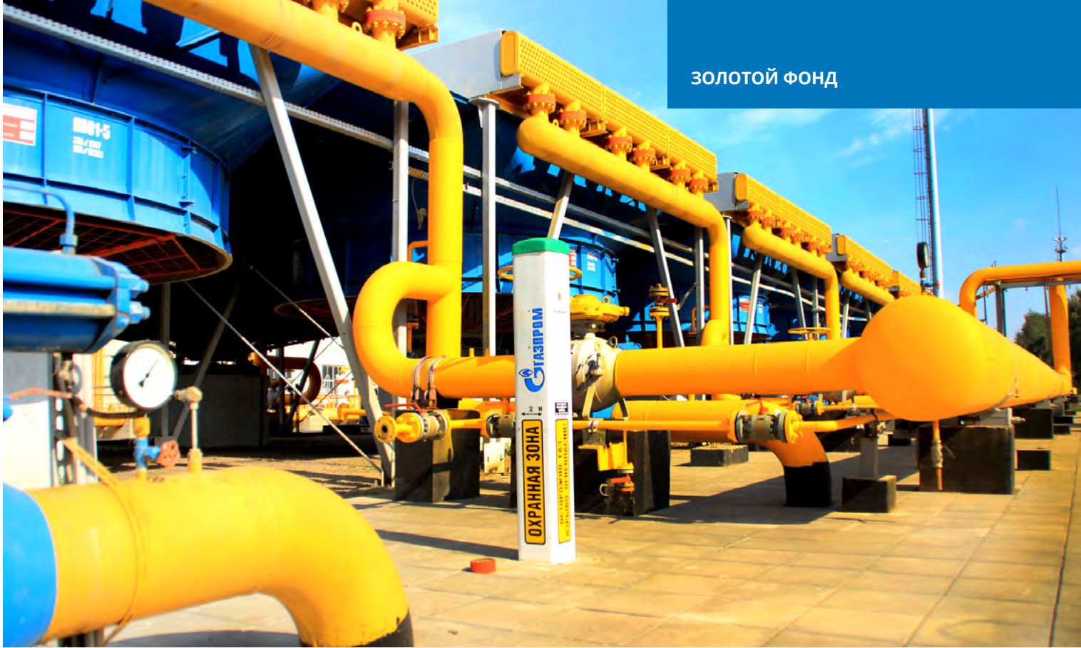
Аппараты воздушного охлаждения газа Краснодарского ПХГ
