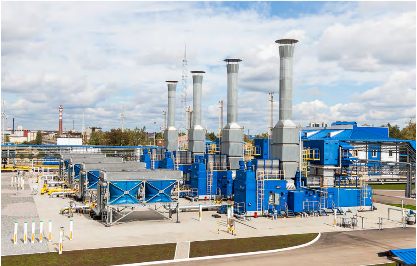
Газоперекачивающие агрегаты Московского УПХГ
