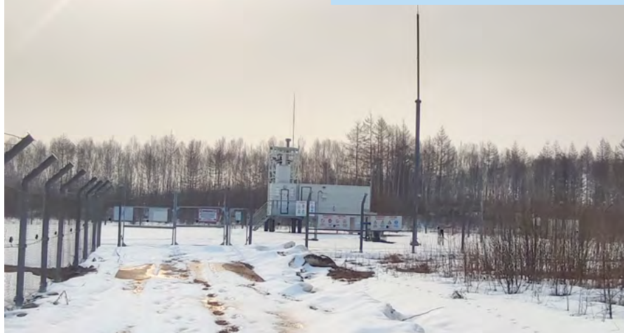
Газопровод-отвод и ГРС Победино Сахалинской области
